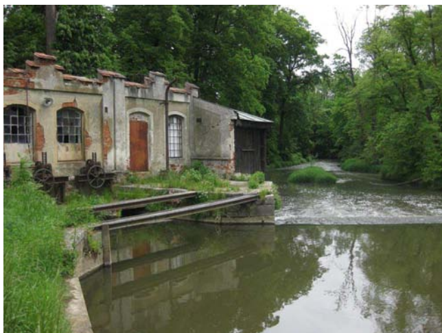
Nefunkční MVE na levé straně
