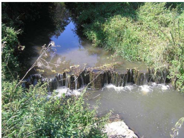
Typický stabilizační stupeň, chybí kamenný zához
