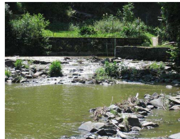
Poškozená levá strana jezu
