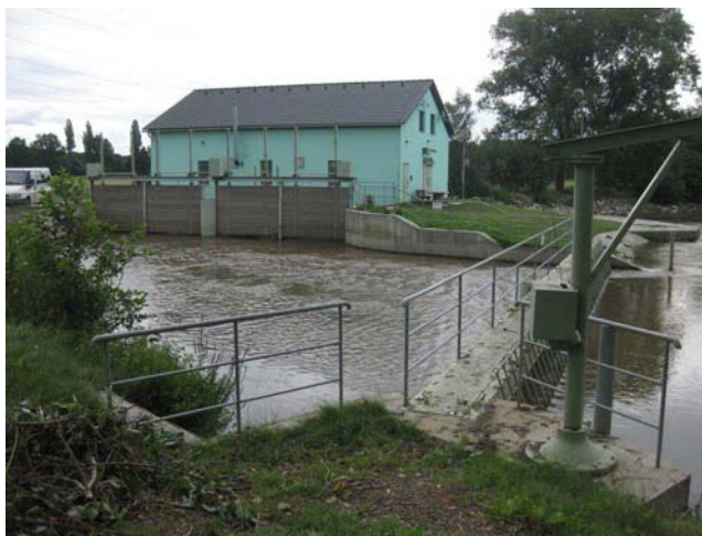
Pohled na nátok na levobřežní MVE
