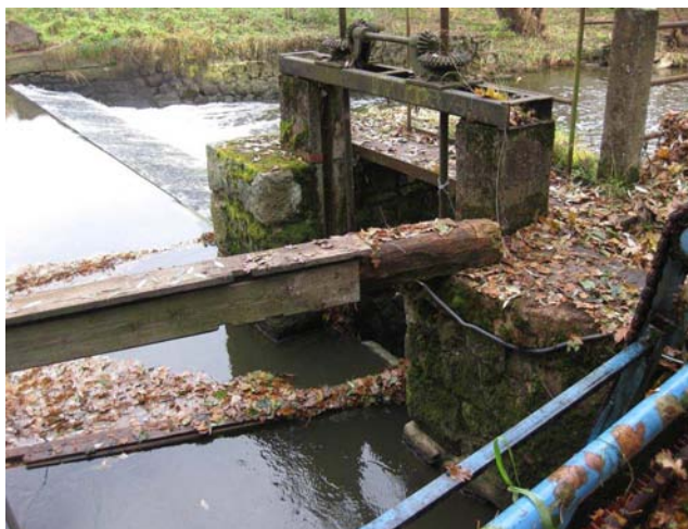
Proplachovací propust u nátoku do MVE
