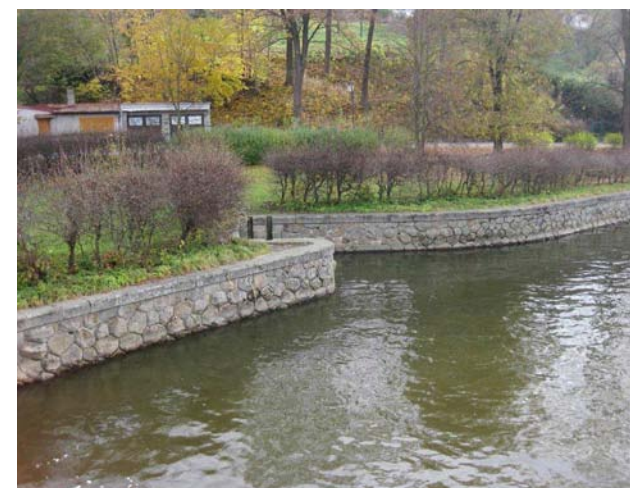
Vyústění odpadního kanálu z MVE
