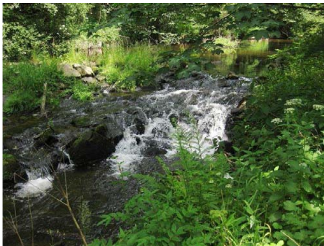
Detail poškozeného jezu
