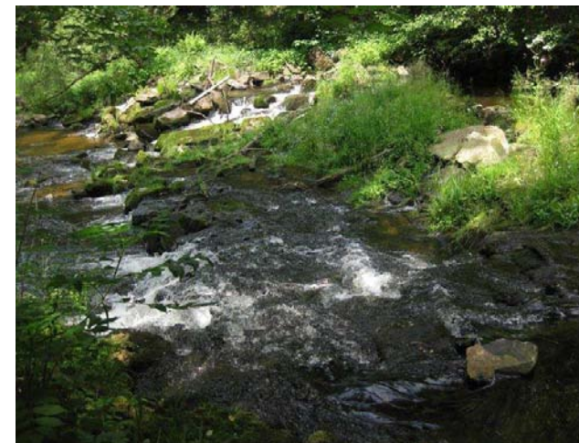
Pohled na poškozený jez
