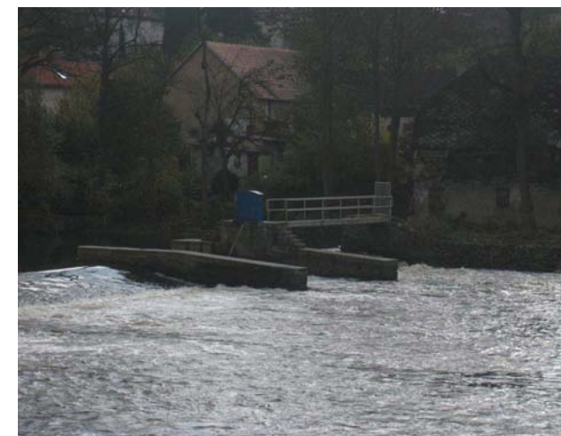
Detail levé strany jezu s vorovou propustí a nefunkční MVE
