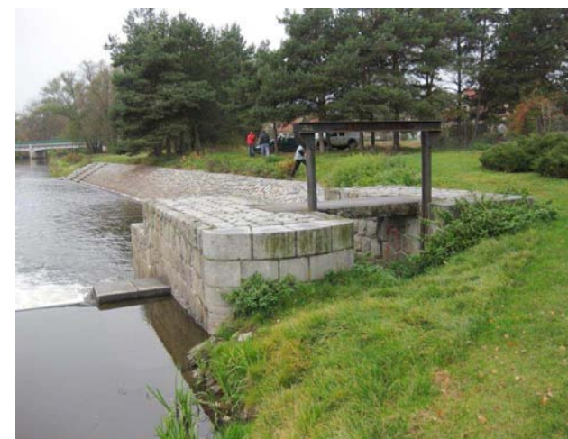
Nefunkční jalová propust
