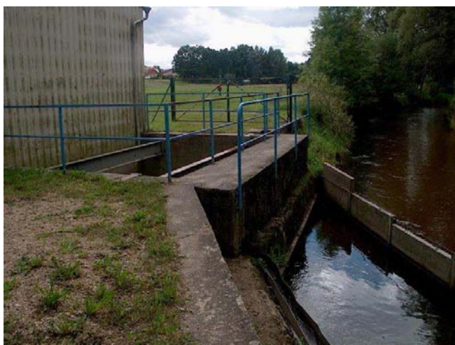
Výúst z čistírny odpadních vod
