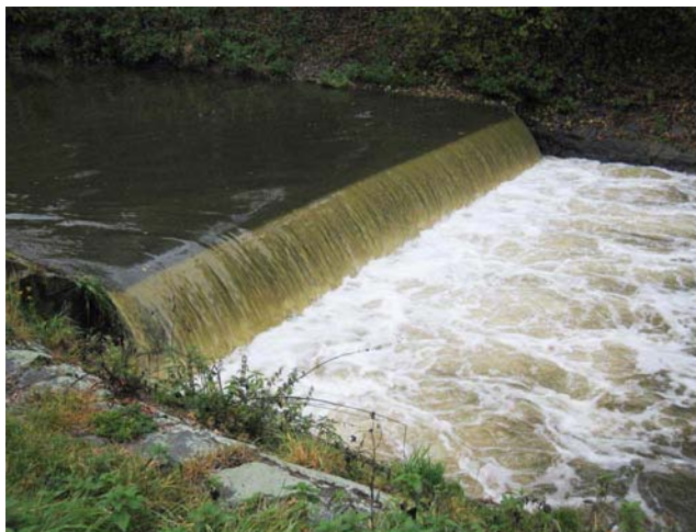
Detail přelivné hrany, pod jezem se tvoří válec
