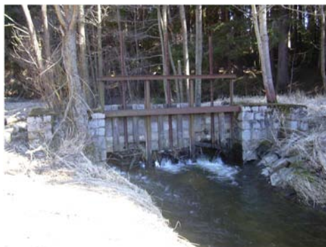
Pohled na stavidlo
