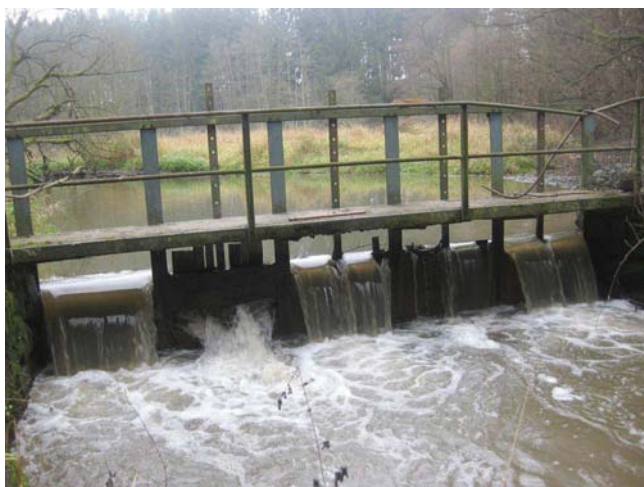
Pohled na stavidlo
