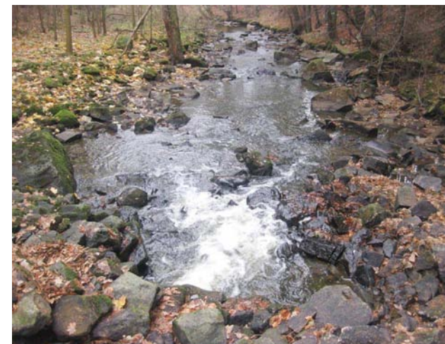
Vyústění trouby zajišťující MZP
