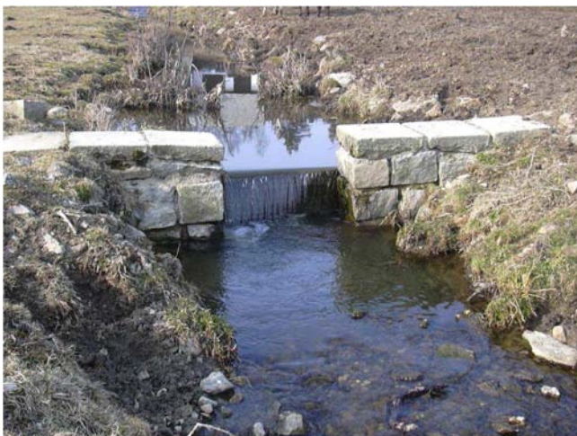
Pohled na stavidlo
