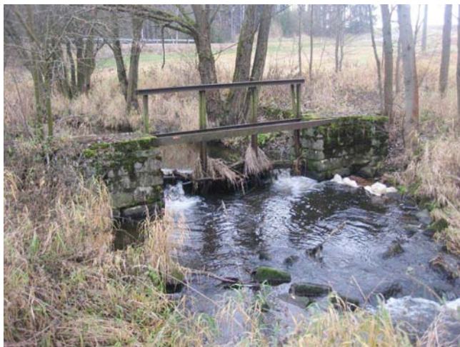
Pohled na nefunkční stavidlo
