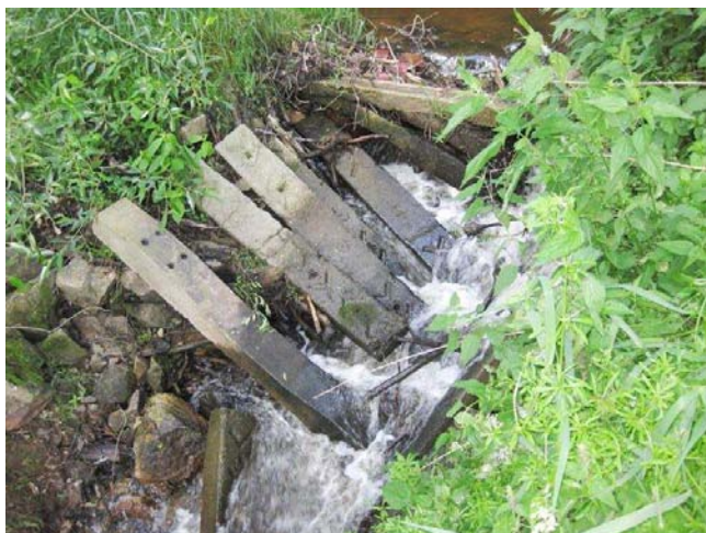
Detail poškozeného jezu
