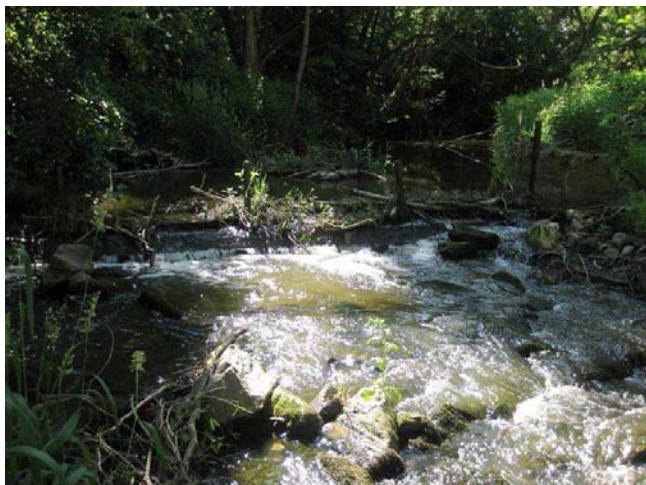
Pohled na poškozený jez
