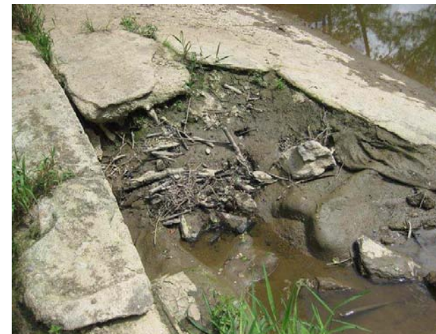
Poškozené těleso jezu
