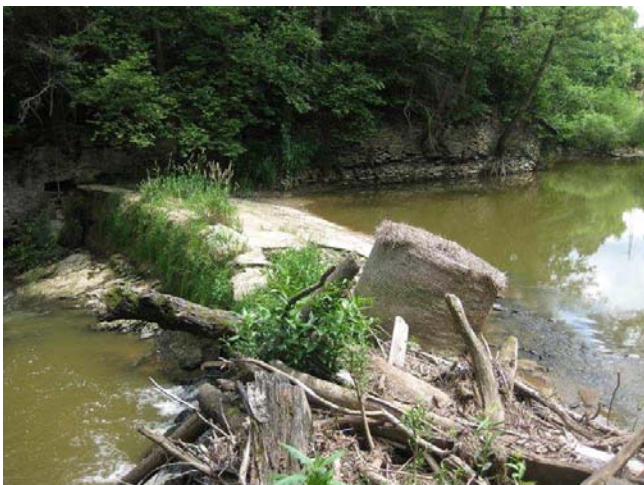
Pohled na poškozený jez a pravý břeh
