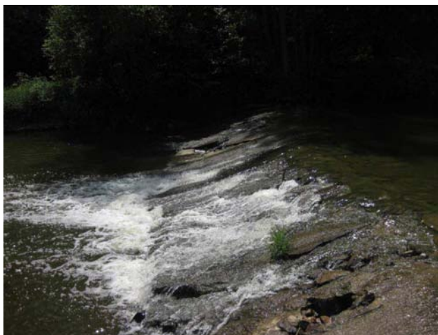
Poškozené těleso jezu
