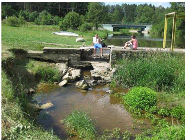
Poškozený pravý břeh u jezu
