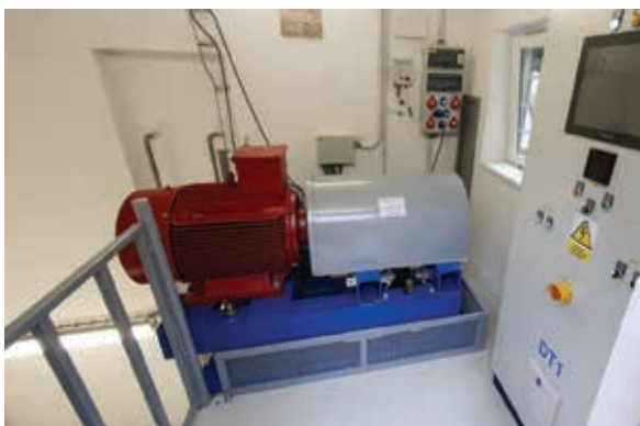
MVE Loučovice – rekonstrukce technologie – generátor
