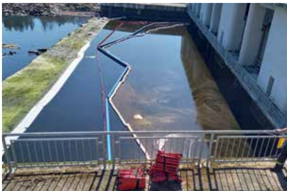
Únik hydraulického oleje z VE Kamýk zajištěný nornými stěnami – havárie, Vltava, Kamýk nad Vltavou 23. 3. 2022
