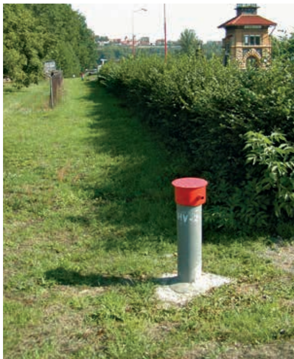
Pozorovací vrt u plavebních komor v Hořině
