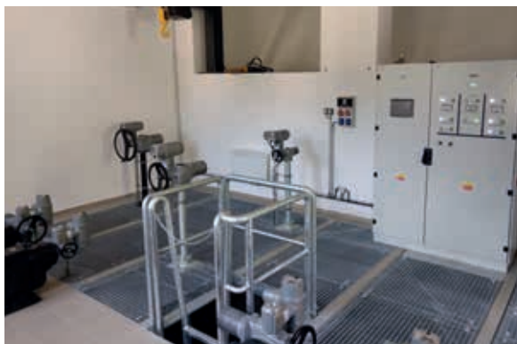
VD Husinec – pohled do strojovny
