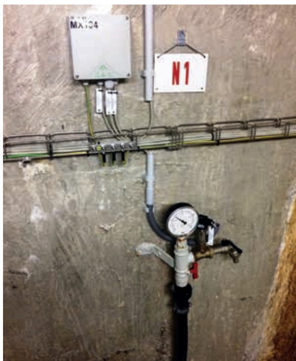
VD LUČINA – MONITOROVACÍ SYSTÉM TBD A PROVOZNÍCH VELIČIN
