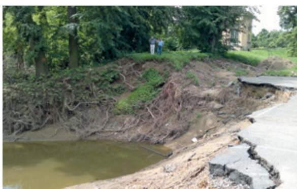
Ochranná hráz Veltrusy, u Laudonova pavilonu – po povodni
