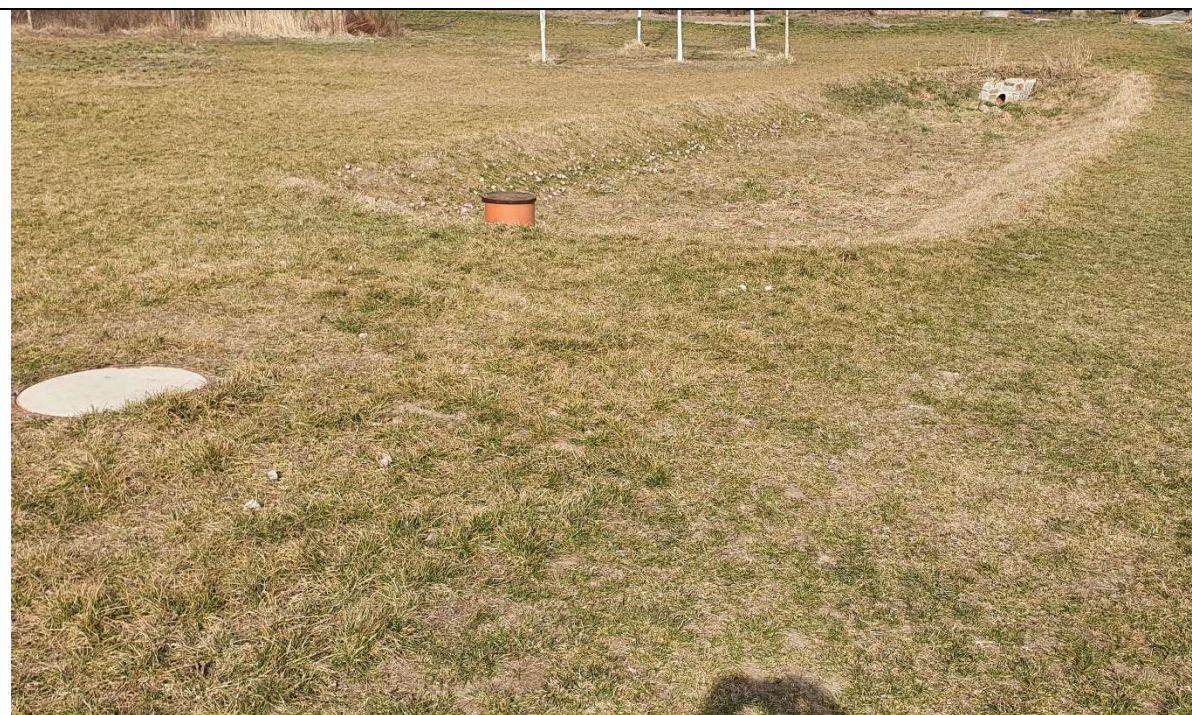
Příklad kombinace vsakovacího průlehu a vsakovací rýhy v k.ú. Syrovice (foto AQUATIS a.s.)
