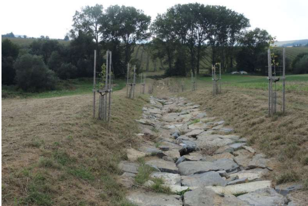
Svodný průleh v k.ú. Pašovice na Moravě (Zdroj: http://soutezsr.spucr.cz )
