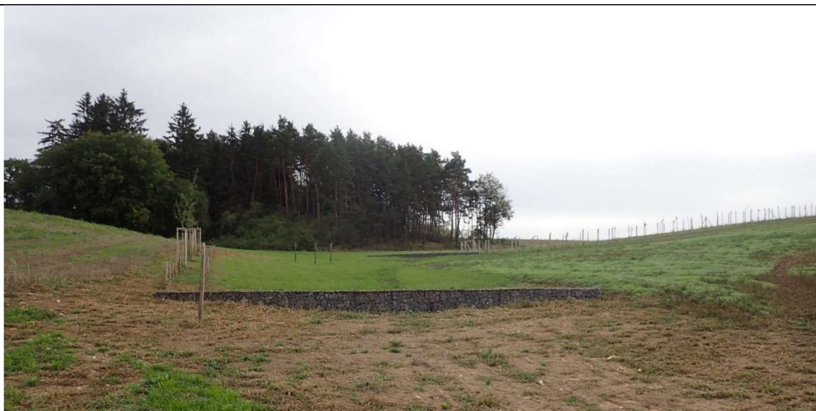
Gabionové přehrážky v DSO v k.ú. Říčky (okres Brno-venkov) (zdroj: VÚV TGM, v.v.i.)
