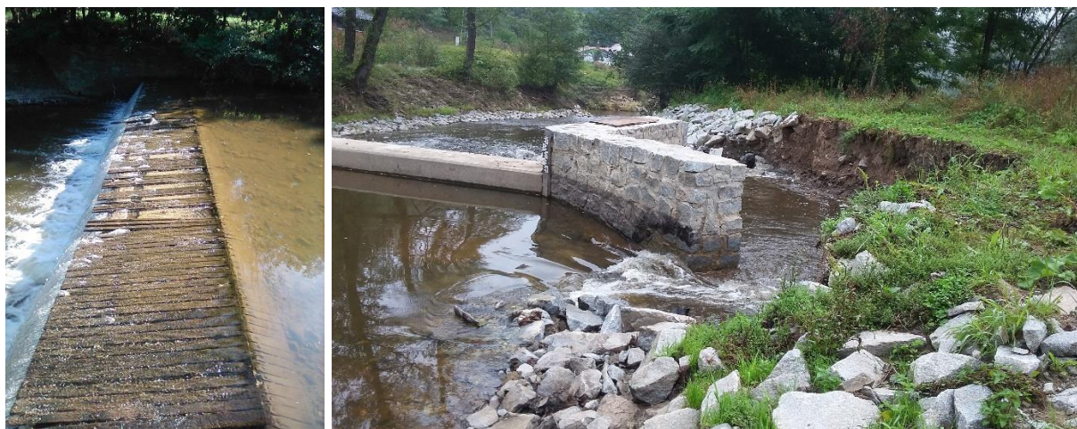
škody způsobené průchodem povodně na Klabavě v Rokycanech (zdroj: protokoly o pov. škodách PVL) vlevo jez ř. km 23,043 a vpravo jez ř. km 2,292
