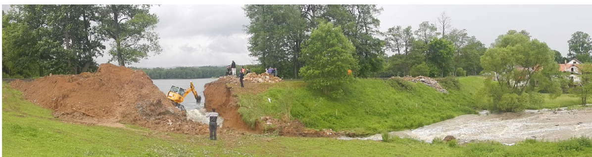
Obrázek 2 – Fotografie nouzového přelivu a místa poruchy
