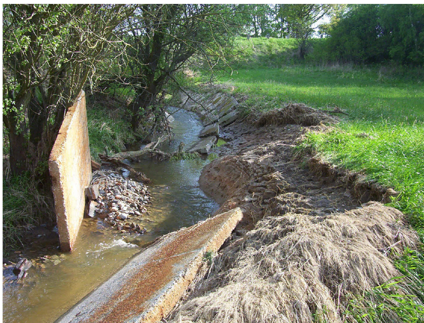
Obrázek 3 – Radinovský potok, poškození břehového opevnění u Štěpánova
