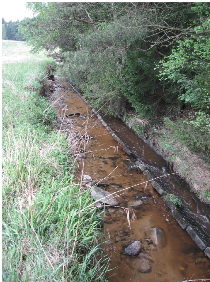
Obrázek 4 – Hejnický potok, poškození břehového opevnění u Ústí
