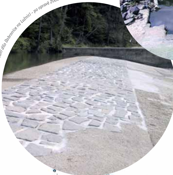
Vodní dílo Dobronice na Lužnici – po povodních 2006.
